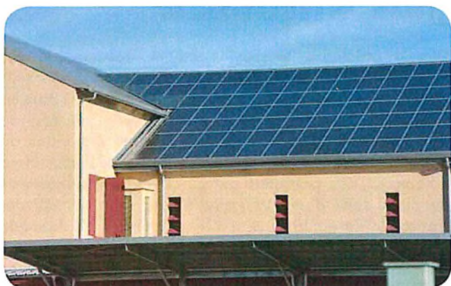
Panneaux solaires sur Bâtiment d'entreprises - Bonnieux.
