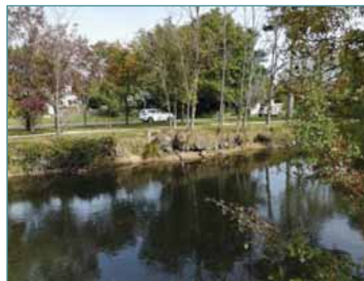
Site avant intervention : érosion très marquée sur 100 mètres
