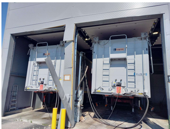
Fig. 6 – Sinistre porte FMA du bâtiment OMr
