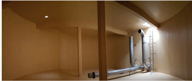
Réservoir du MotoCross à Pertuis
